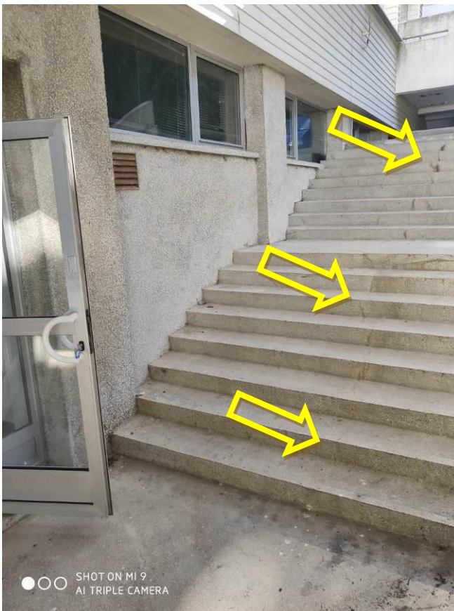
Zdjęcie nr 11 – Pęknięcia lastriko na schodach do piwnicy segmentu C
