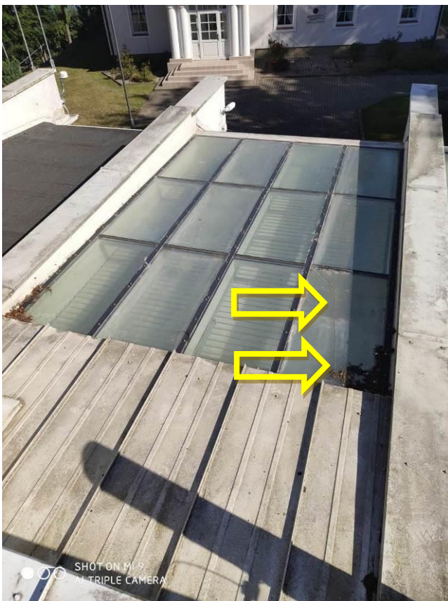
Zdjęcie nr 23 – Pęknięcie tafli szkła nad salą wykładową
