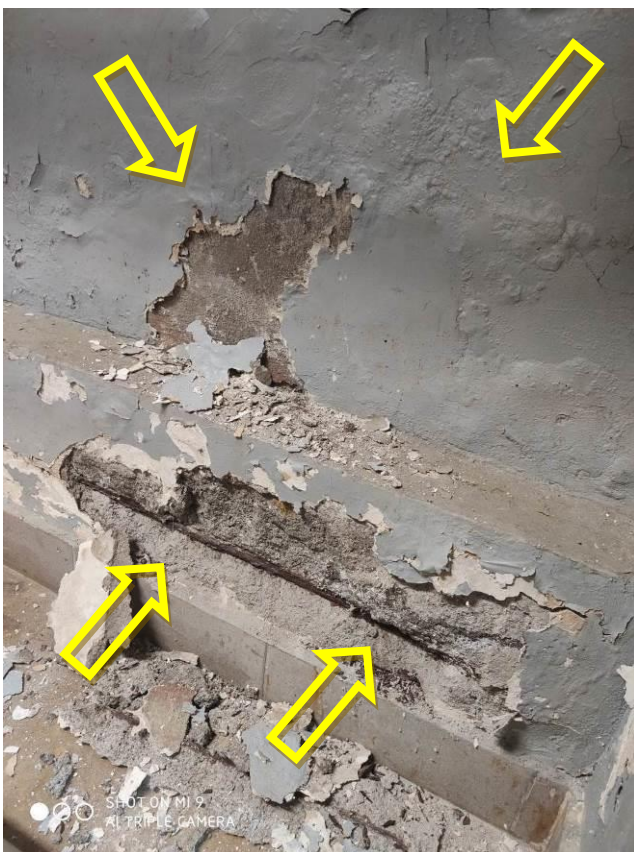
Zdjęcie nr 03 – Purchle i odspojenia tynków, korozja zbrojenia ławy na ścianie wewnętrznej (A)
