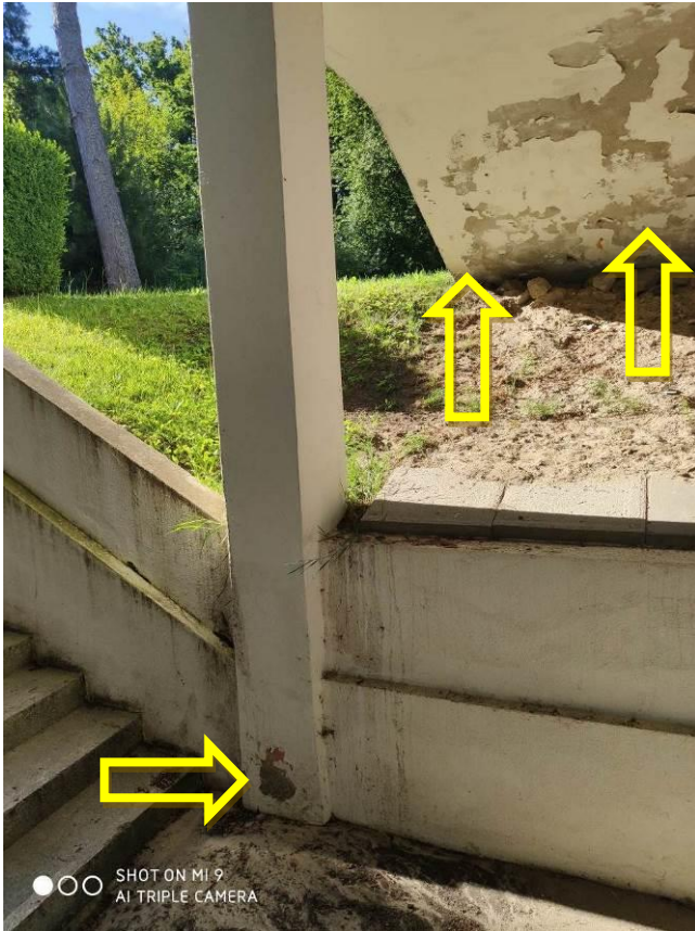
Zdjęcie nr 08 – Pęknięcia i odspojenia tynków na schodach głównych do segmentu C
