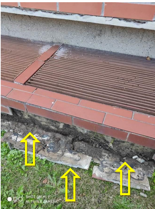
Zdjęcie nr 06 – Odspojenia płytek na doświetlu okienny przy segmencie A
