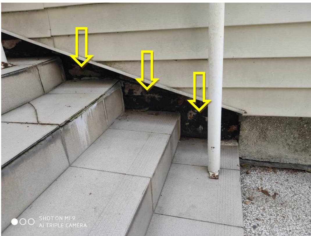
Zdjęcie nr 12 – Uszkodzona izolacja na budynku C przy schodach pomiędzy częścią B i C
