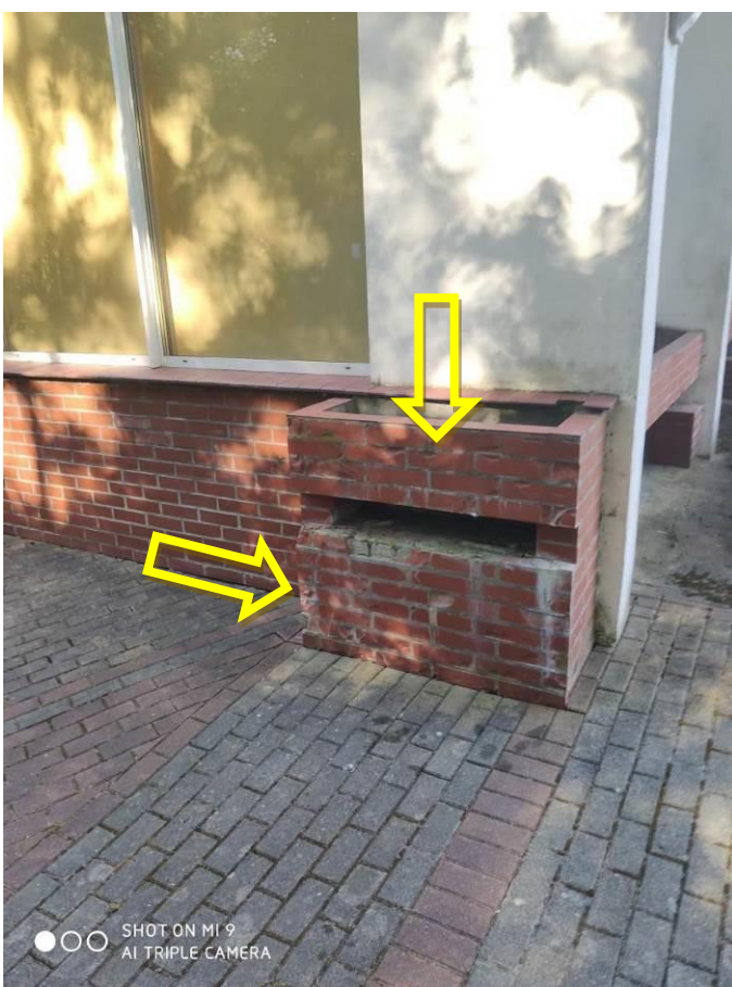
Zdjęcie nr 13 – Uszkodzony kwietnik z klinkieru przy segmencie C od strony wschodniej
