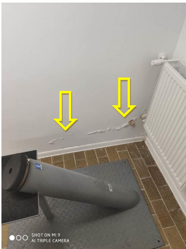
Zdjęcie nr 04 – Purchle i pęknięcia tynków na ścianie zewnętrznej w piwnicy (segment A)
