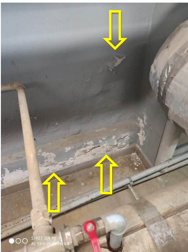
Zdjęcie nr 02 – Purchle i odspojenia tynków na ścianie wewnętrznej w piwnicy (segment A)
