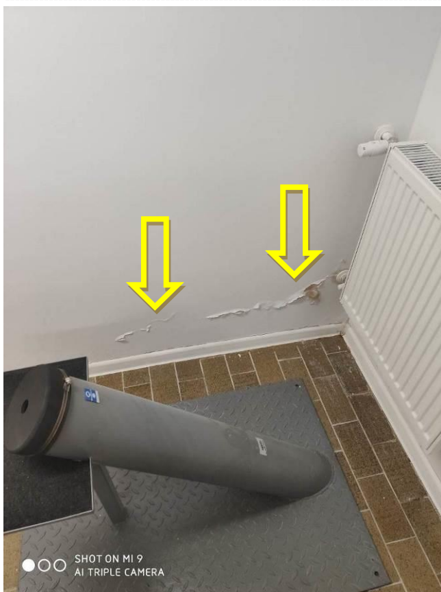
Zdjęcie nr 04 – Puchle i pęknięcia tynków na ścianie zewnętrznej w piwnicy (segment A)
