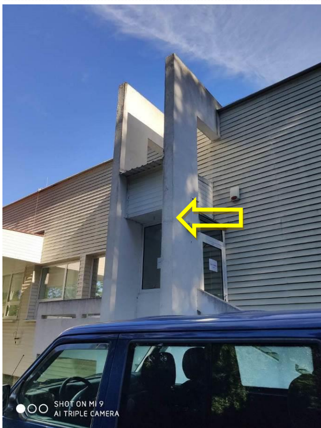
Zdjęcie nr 20 – Elementy żelbetowe przeznaczone do remontu i termomodernizacji
