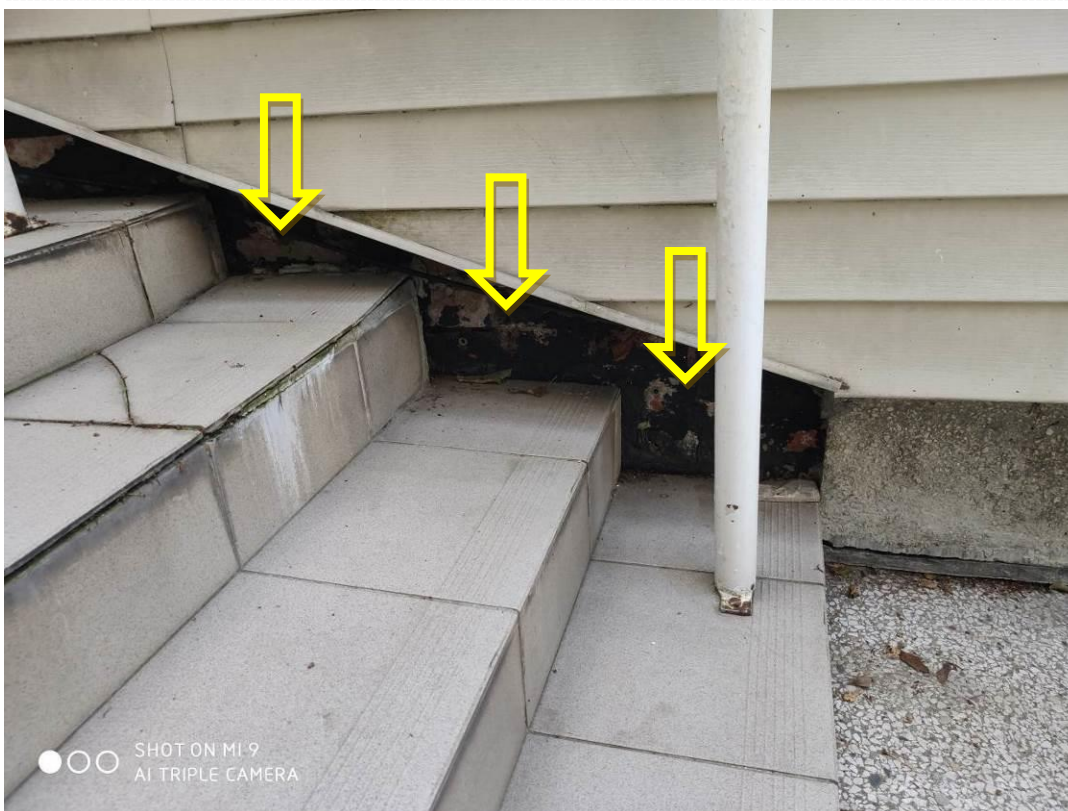
Zdjęcie nr 12 – Uszkodzona izolacja na budynku C przy schodach pomiędzy częścią B i C
