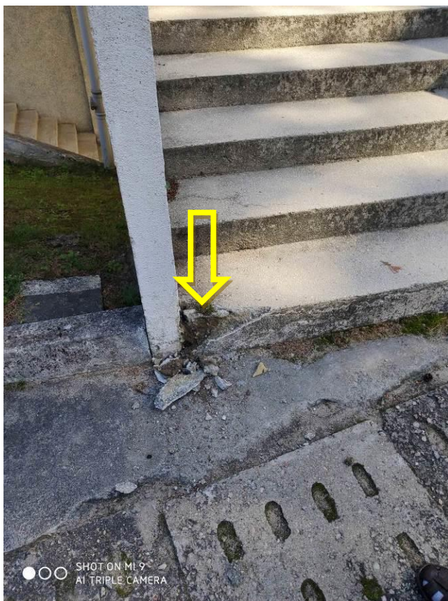
Zdjęcie nr 09 – Pęknięcia i odspojenia lastriko na schodach głównych do segmentu C
