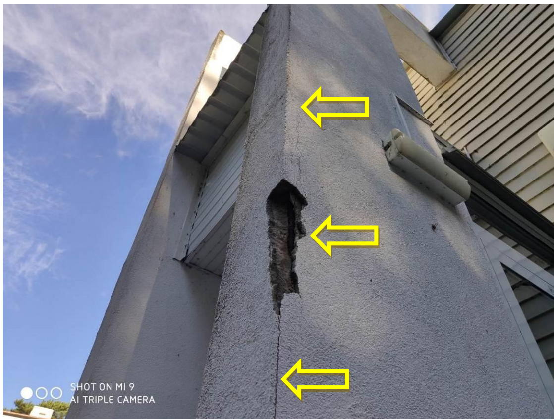
Zdjęcie nr 21 – Pęknięcia tynków i otuliny oraz korozja zbrojenia
