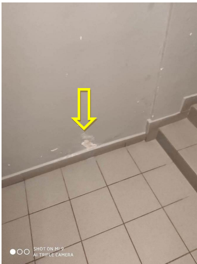
Zdjęcie nr 05 – Puchle i pęknięcia tynków na ścianie wewnętrznej w piwnicy (segment C)
